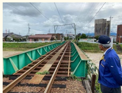
上高地線の橋梁の陥没現場にて
