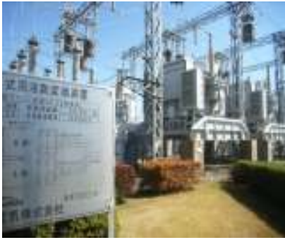
朝日村にある東京電力新信濃発電所の旧周波数変換設備
